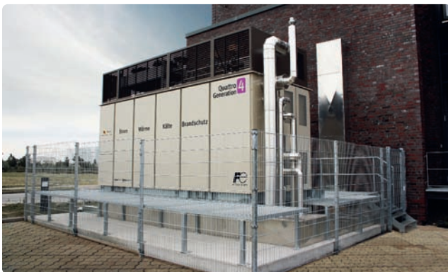
Nachrüstbar: Eine Phosphorsäure-Brennstoffzelle lässt sich auch nachträglich an ein vorhandenes Rechenzentrum anschließen (Abb. 1).
