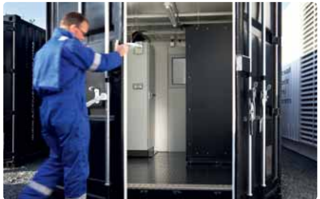
Der Blick in das Innere der Stromversorgungs-Container zeigt die Platznot (Abb. 6)
