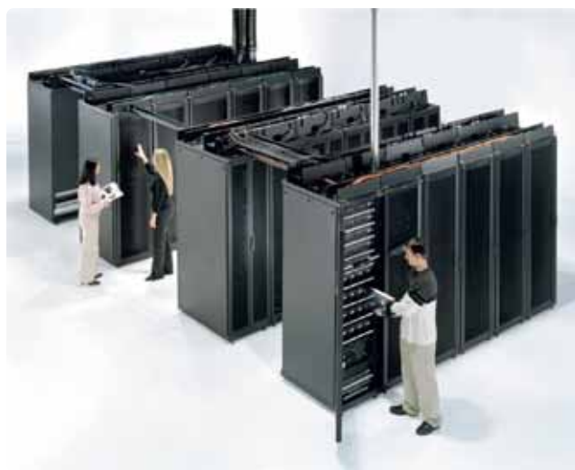
Bei konsequentem Einsatz der Reihenkühlung lässt sich eine Doppelbodenkonstruktion im RZ vermeiden (Abb. 2).
