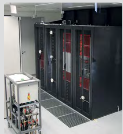
Blick in die Testumgebung des Datacenter 2020
