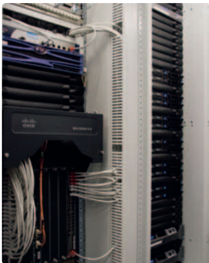
Kaltbereich mit konsequenter Kalt-/Warmgangtrennung (Abb. 3)
