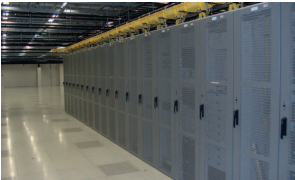
Erhebliches Optimierungspotenzial im Rechenzentrum verspricht die reihenbasierte Kühlung (Abb. 1).
