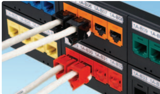
Physische Security für die Verkabelung (Abb. 3)
