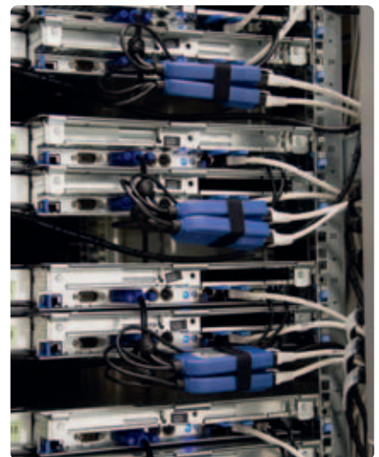
Verkabelung im Warmgang an der Außenseite der Einhausung (Abb. 5)
