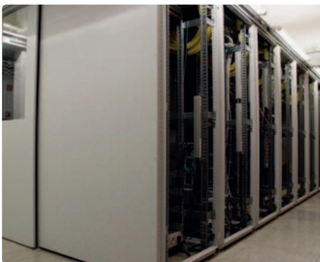
Konsequente Auftrennung in Warm- und Kaltgang hilft beim Umsetzen der Richtlinien zur Energieeffizienz (Abb. 1).
