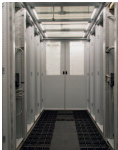
Einhausung der Kaltgänge – Doppelbodensystem Swap Panel 9 (Abb. 4)
