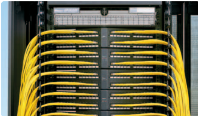
Optimales Kabelmanagement im 19-Zoll-Verteiler (Abb. 2)
