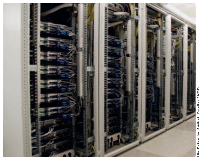
Die Warmluftgänge befinden sich hinter den Racks und erleichtern so das Abführen der anfallenden Wärmemengen (Abb. 2).
